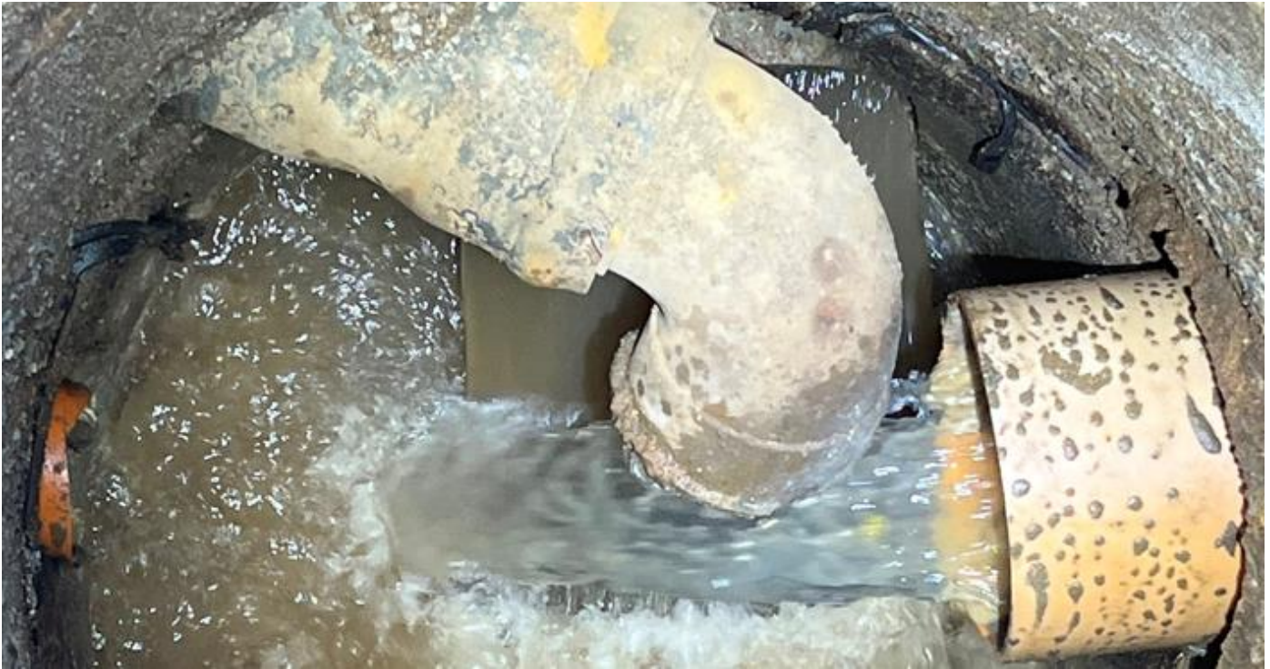
Figur 15: Innlekk av fremmedvann i en spillvannskum. Bilde fra kommunens arkiv.
